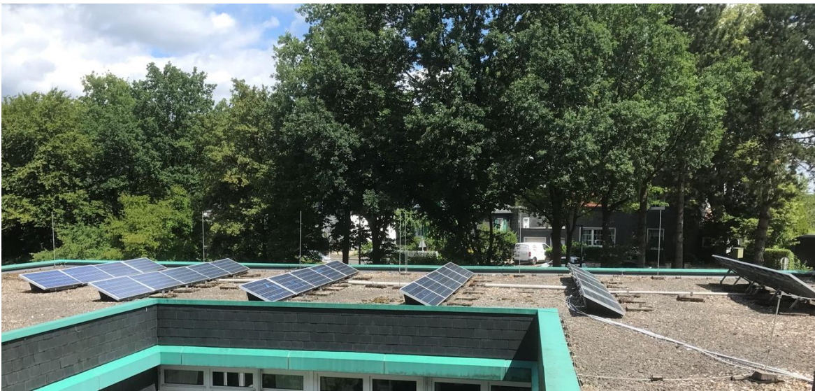
Abbildung 6: Photovoltaik-Anlage auf dem Dach des Schulgebäudes
