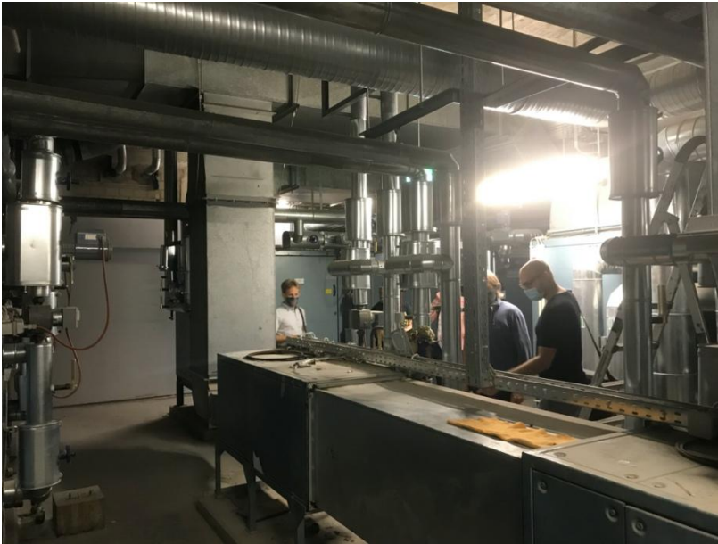
Abbildung 4: Heizungskeller der Schule
