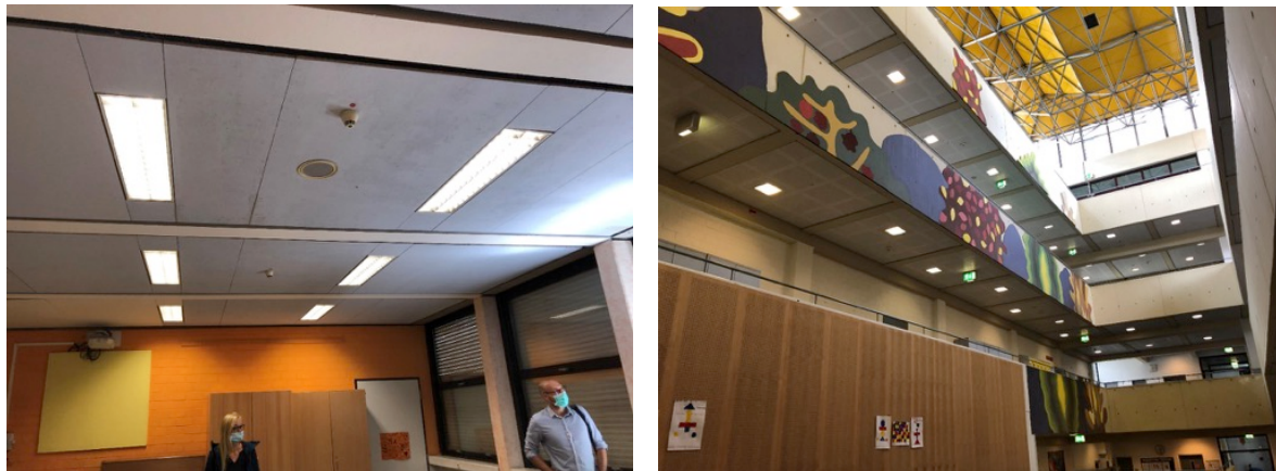
Abbildung 2 a / b: Beleuchtung in Eingangshalle und Fluren sowie in den Klassenzimmern
