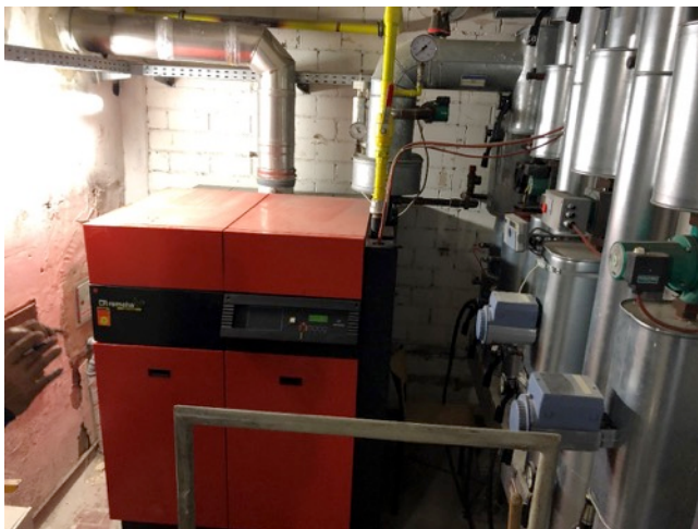
Abbildung 6: Heiztechnik für Turnhalle, Gas-Boiler
