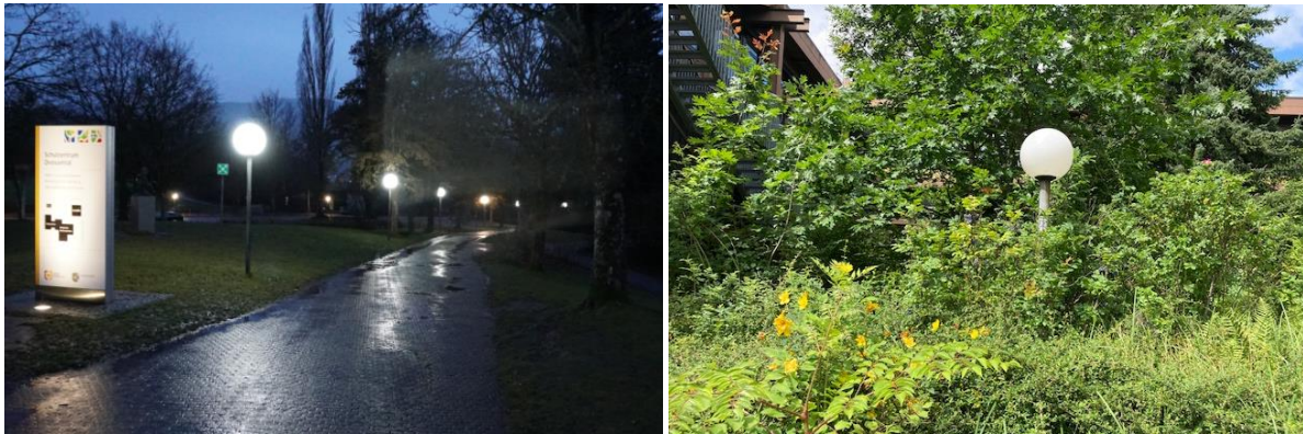
Abbildung 7: Außenbeleuchtung im Schulzentrum
