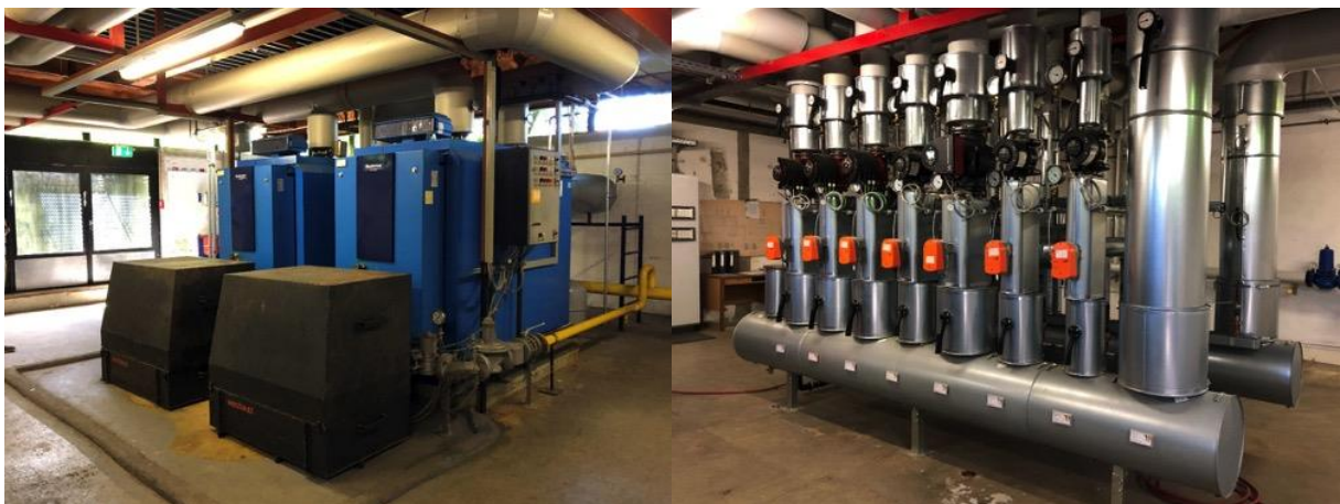
Abbildung 9: Links: Heizungsanlage des Schulzentrums Dreisamtal, bestehend aus zwei Gas-/Ölbrennern mit Baujahr 1982 und zwei Heizkesseln mit Baujahr 1997 (blaue Farbe) Rechts: Wärmeverteilungssystem
