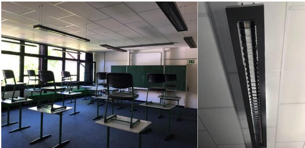
Abbildung 17: Links: Klassenzimmer mit sanierter Beleuchtung Rechts: Moderne Leuchte mit LED-Technik
