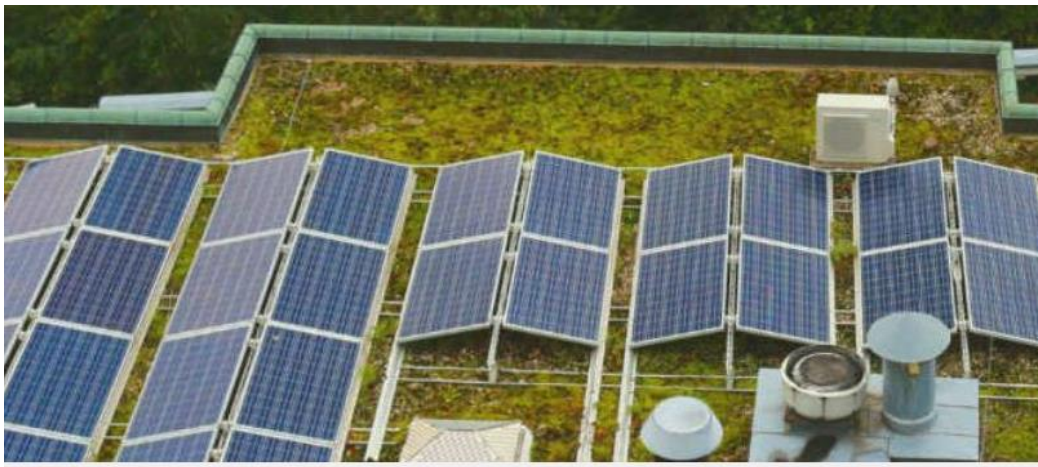
Abbildung 31: Beispiel für eine PV-Anlage mit Ost-West Ausrichtung und flach angebrachten Modulen, die eine möglichst geringe Angriffsfläche für den Wind bieten.
