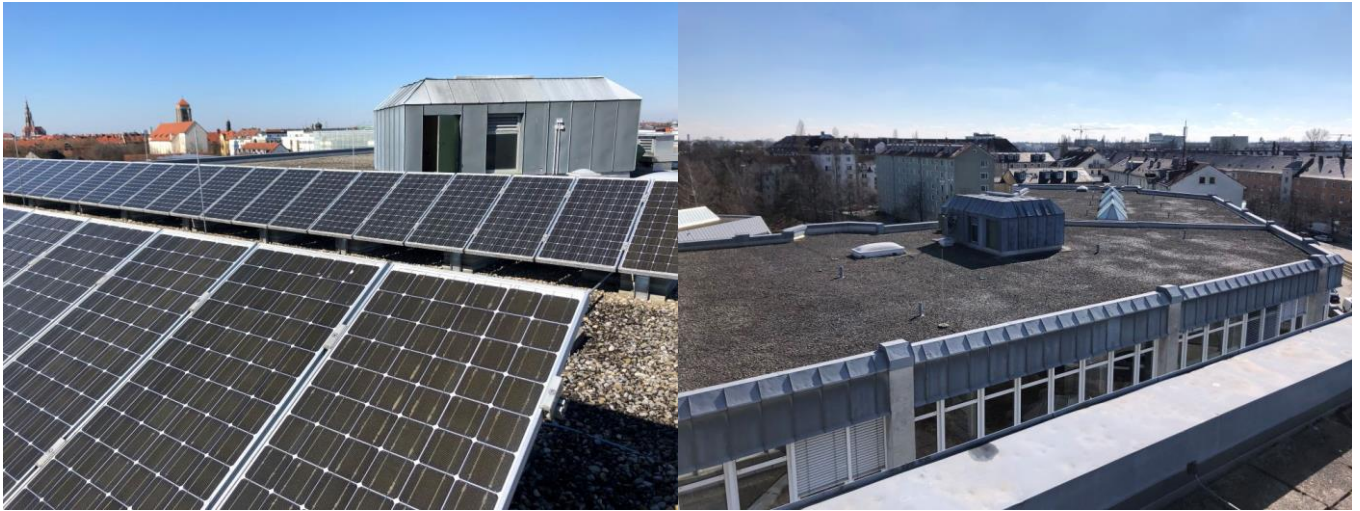
Abbildung 7: Links: Solaranlage auf dem Dach des Gebäudekomplexes, Rechts: Noch freie Dachflächen.
